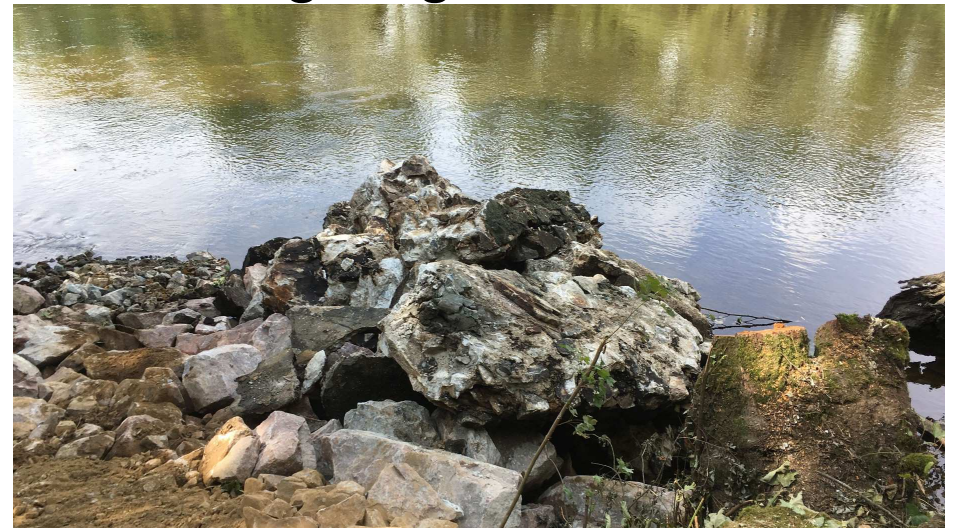
Les blocs triés sont mis en attente sur la rive gauche avant d'être transportés vers une décharge agréée
